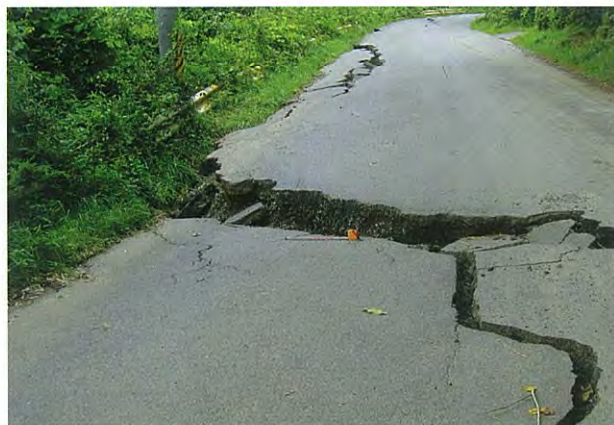
4. 河南町北村(高寺付近)における路面の亀裂と段差。道路造成時の盛土部分が陥没して生じたものと考えられる。
