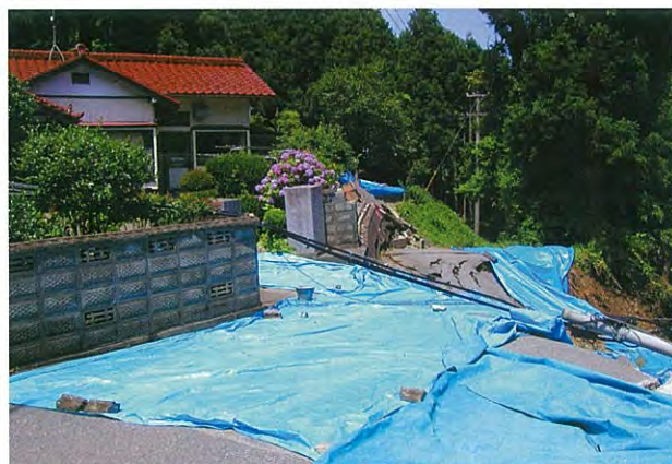
3. 河南町北村(旭山南方)における急斜面の崩壊。民家前の道路部分が写真右下に滑り落ちている。
