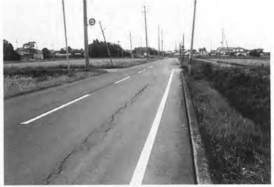
写真2 道路面の沈下と電柱の傾き。堤間湿地帯を走る道路で、道路面の沈下の被害が大きい。前方に浜堤上にある鳴瀬町牛網の集落が見える。
