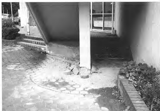
写真6 鉄筋コンクリート建物周囲に認められる地盤沈下と噴砂痕。建物は背湿地上に建設されており、周囲の地盤が不同沈下を起こしている(鳴瀬町小野の中央公民館; Loc.11)。
