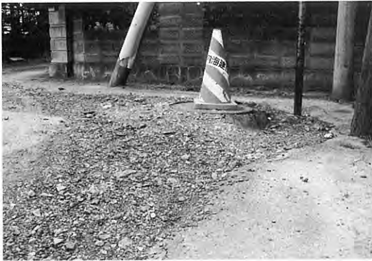
写真1 道路面の沈下とマンホールの浮上がり。沈下被害を受けた道路では、写真にあるとおり砂利で応急修復されている(鳴瀬町小野; Loc.12)。
