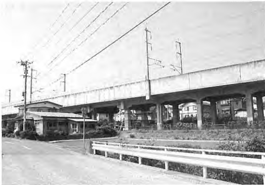
第2図 ラーメン構造の橋脚と被災サイト(矢巾町北郡山において)。
