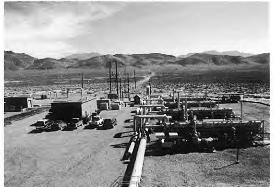
第3図 エンパイアー地熱発電所。左手の車が停まっている小さな建物が管理オフィスである。
