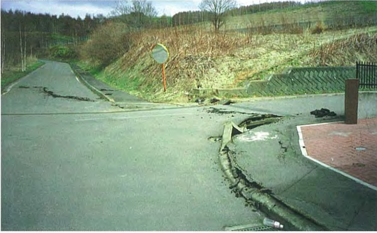
6. アスファルトや縁石の変形. 虻田町高砂地区(2000年4月16日撮影).
