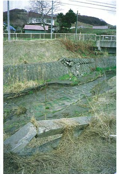
8. 板谷川では地殻の圧縮で堤防の破損が見られた(2000年4月16日撮影).
