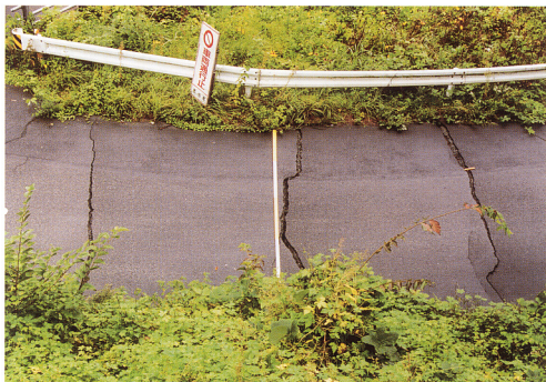
3. 国道と交差する旧道に現れた路面の亀裂、亀裂は3本認められ、両側の亀裂に扶まれたブロックが反時計回りに回転している。スケールは5mだが、1m程度植生に隠れている(鳥取県西伯町笹畑)。
