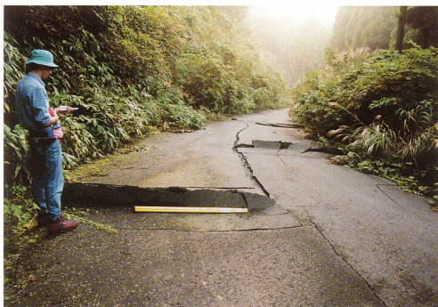
4. 鎌倉山北北東の鎌倉山グリーンラインで見られた路面の変形、変形は、道路に直交する方向の左ステップの短縮変形と、道路に平行な方向の開口亀裂の組み合わせで構成され、道路に時計回りに斜交する断層の左横ずれ変位によるものと推定される。スケールは1.3m。
