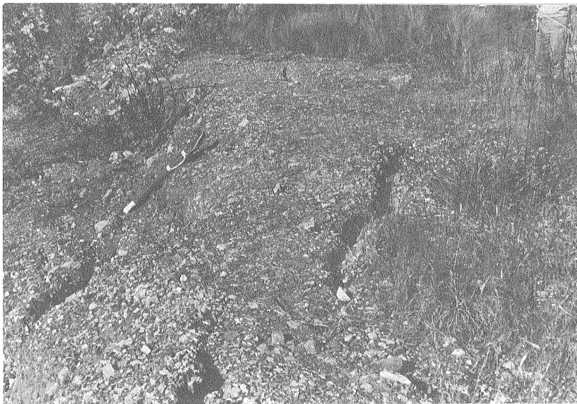
2. 地割れ (測点No. 24の東方)
