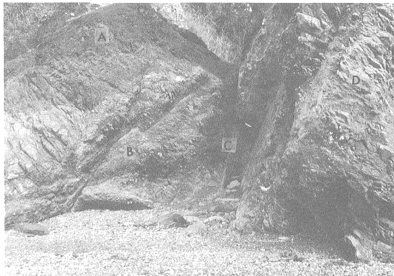
A：中甕層紫赤色泥岩，B：中甕層の破碎された凝灰質泥岩，C：断層破碎帯，D：姫浦層群砂岩泥岩互層。
