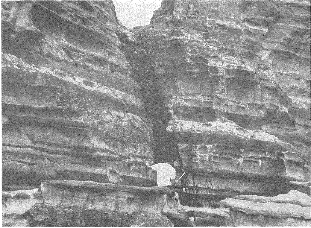
1 Y-EW系断層. 断層面は開口しており, 異物によつて充填されている。
