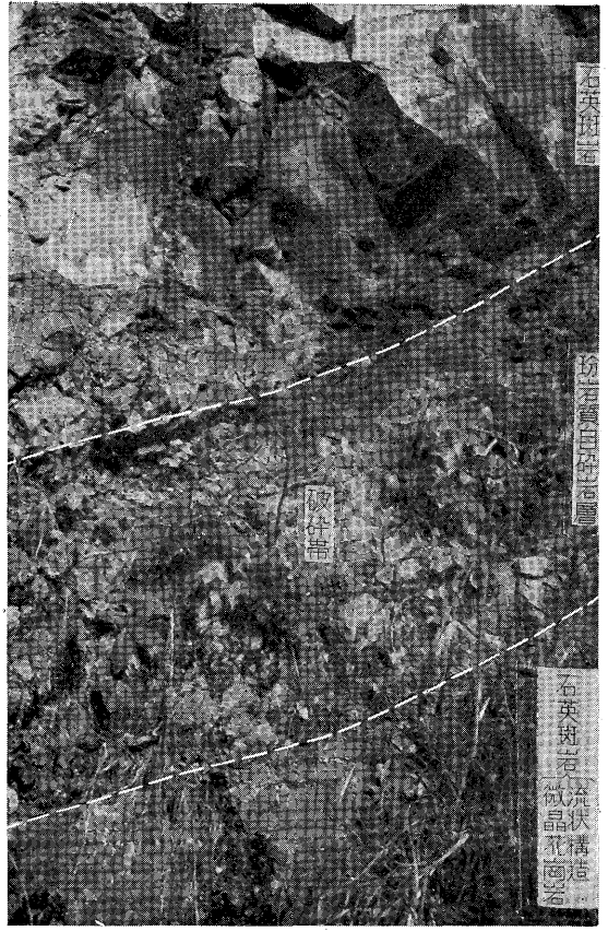
図版 18c 上口羽崖崩れ破砕帯の細部
