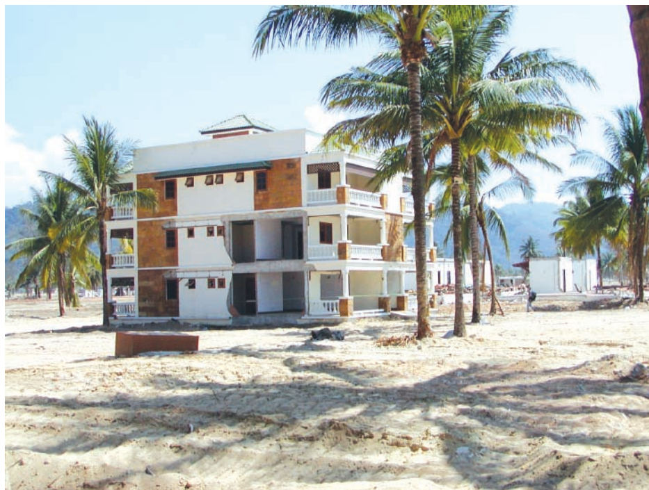
第11図. Bang Niang Beachにおける津波被害. この建物の2階に津波の痕跡があった. Fig. 11. Damaged building in Bang Niang beach. Tsunami trace was found on the second floor.
