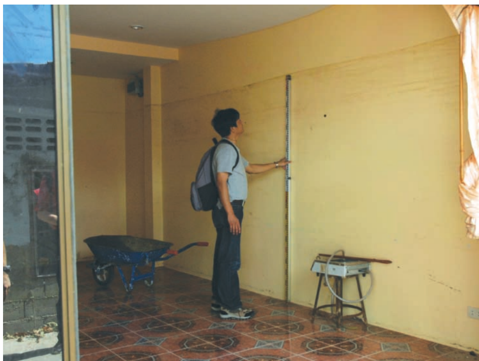
第3図. プーケット島Kamala beachにおける浸水の痕跡. 海岸から約50 mにある家屋内での浸水深は2.04 mであった. Fig. 3. Water mark in a house located about 50 m from coastline of Kamala Beach, Phuket. The inundation depth is 2.04 m.
