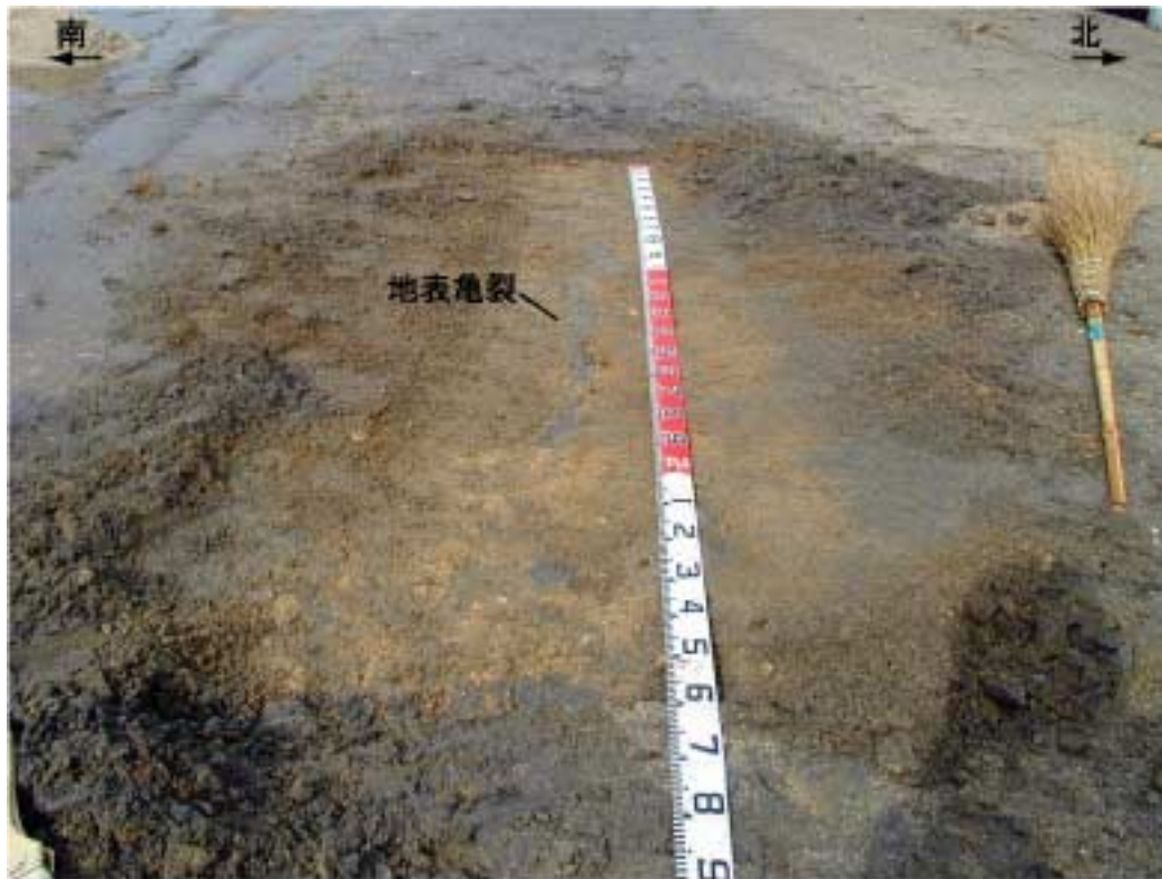
写真5. 噴砂丘E地点の地表亀裂。 Photo 5. Surface fracture under the sand boil (E). 噴砂を取り除いた状態。
