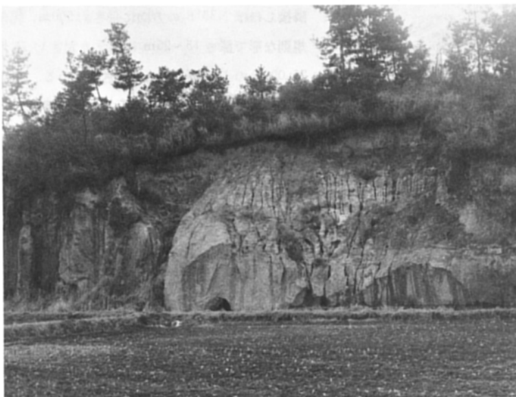
第2図 シラスの崩れ（図幅地域北西隅の東方付近）
