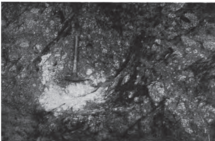
図版2 小出川下流部にみられる花崗閃緑岩の破砕部
