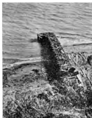
(B) 防波堤と侵蝕状況
